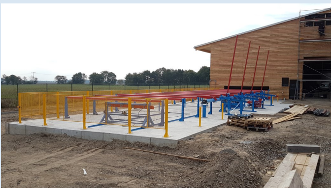
Abstapelanlage mit Truss Stacker
